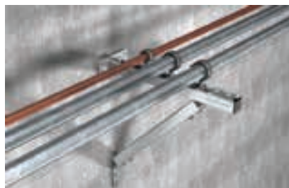
Lekkie instalacje na wsporniku
