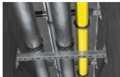
Instalacje rurociągowe w przejściu ewakuacyjnym
