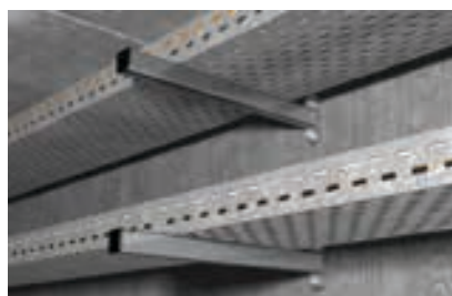
Wsporniki pod trasy kablowe
