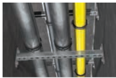
Instalacje rurociągowie w przejściu ewakuacyjnym
