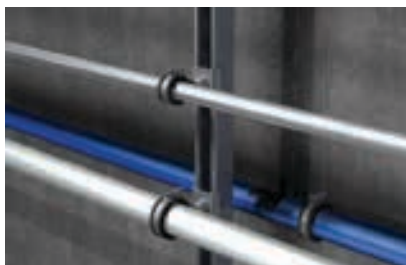
Równoległe rurociągi zamontowane na szynie
