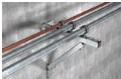
Lekkie instalacje na wsporniku
