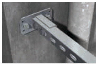
Mocowanie wspornika w szybie instalacyjnym
