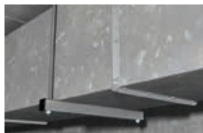
Podwieszony kanał wentylacyjny
