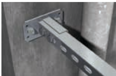
Mocowanie wspornika w szybie instalacyjnym
