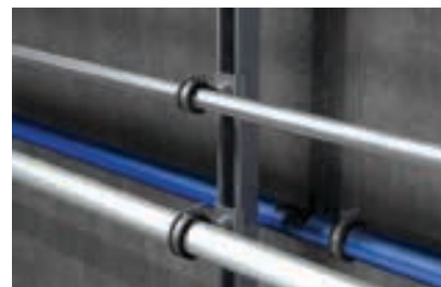
Równoległe rurociągi zamontowane na szynie
