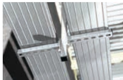
Trasy kablowe na wspornikach
