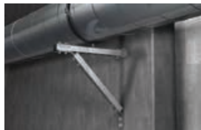
Rurociąg wentylacyjny na wsporniku
