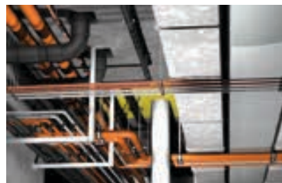
Podwieszenie rurociągów z mediami
