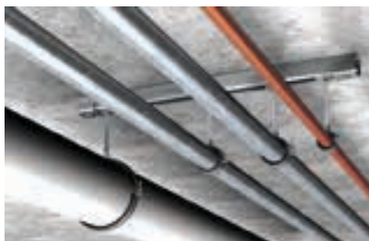
Lekkie rurociągi podwieszane
