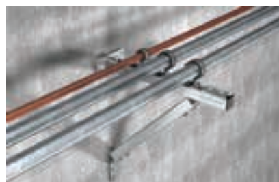
Lekka instalacja rurociągowa na wsporniku
