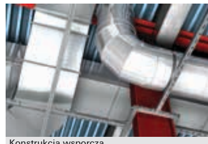
Konstrukcja wsporcza dla kanałów wentylacyjnych
