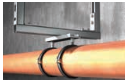
Wydłużenie rurociągów podwieszonych na mocowaniu ślizgowym
