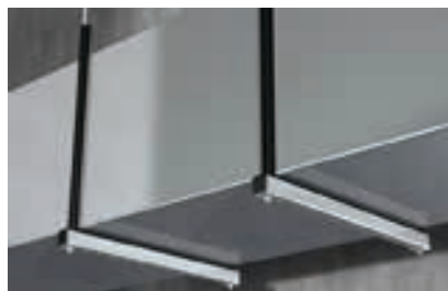
Kanał wentylacyjny podwieszony na szynach z izolacją
