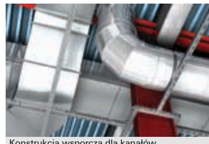
Konstrukcja wsporcza dla kanałów wentylacyjnych
