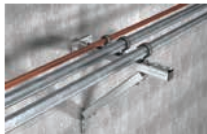
Lekkie instalacje na wsporniku
